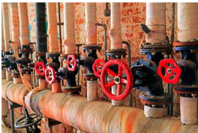
Vannes de chauffage et calorifugeage
