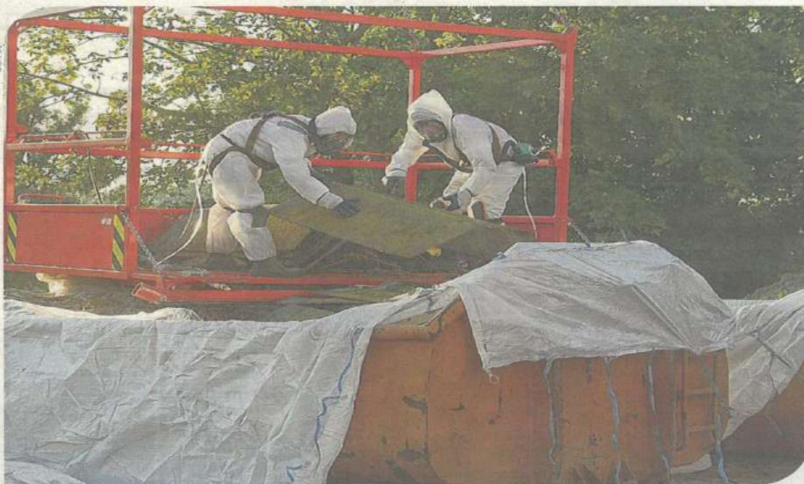
Toute intervention sur des bâtiments contenant de l'amiante doit être effectuée par des entreprises spécialisées.
