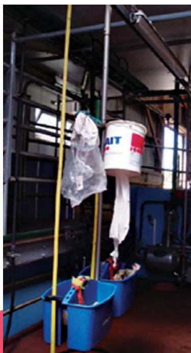
Système de porte-seaux à glissières et tuyau de lavage suspendus
