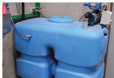
Cuve de stockage d'eau
