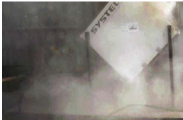
Dépeussierage d'un échangeur d'air
