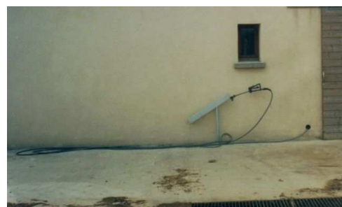
Ici, seuls le tuyau et la lance sont présents sur l'aire
