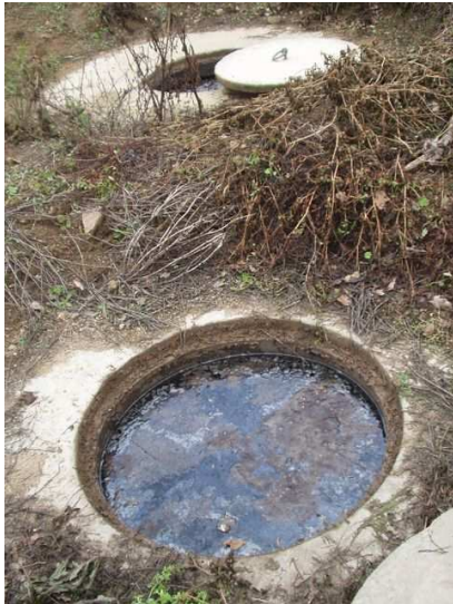
Le regard du débourbeur
